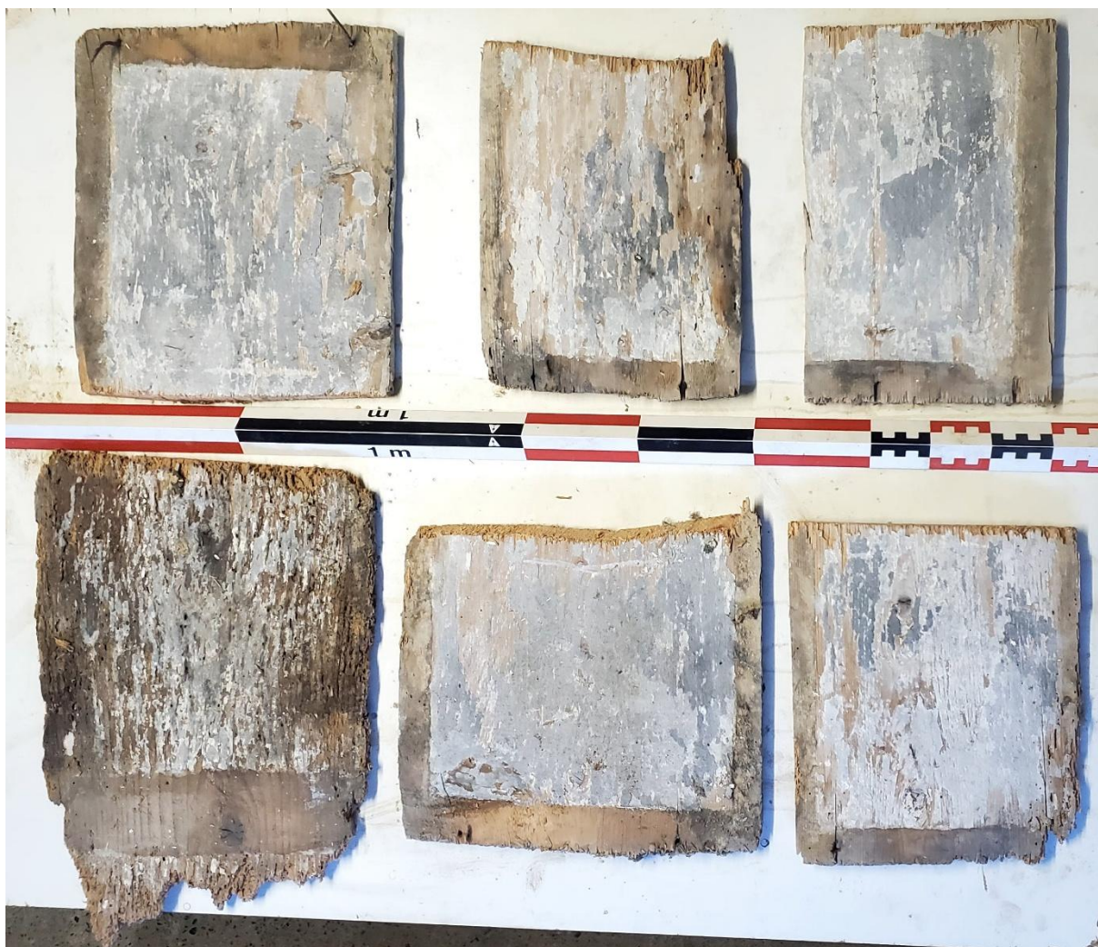
Figure 12 : Les six prélèvements de planches de voliges, en haut le lot découpé entre les sondages 2 et 3 et en bas celui entre les sondages 4 et 5 (Cliché : F. Blondel).
